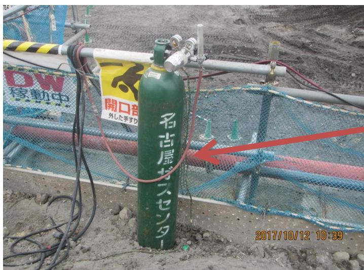
ガス瓶設置状況
